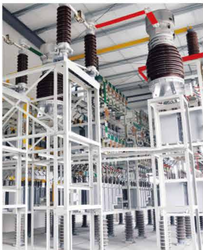
▲ 电容塔 Capacitance Tower
